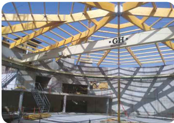
POLAR CRANE 环轨吊
