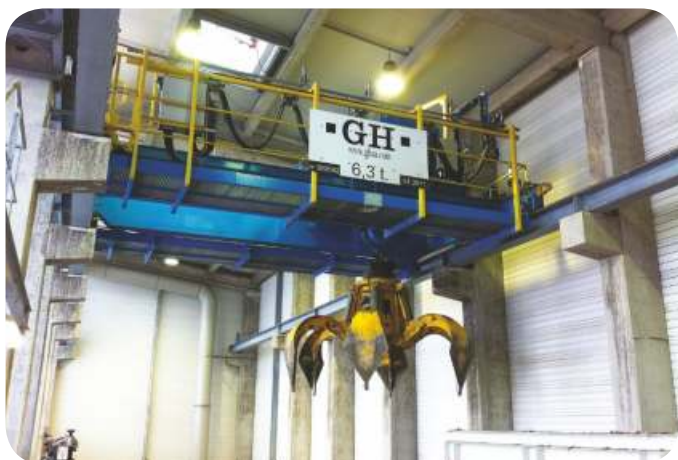
GRAB CRANE 抓斗吊
